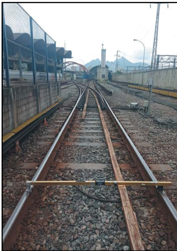
▲ Os dormentes de já aplicados na região do AMV na via principal entre as estações Cidade Nova e Central (Foto: Alex Luiz Dutra da Silva).
