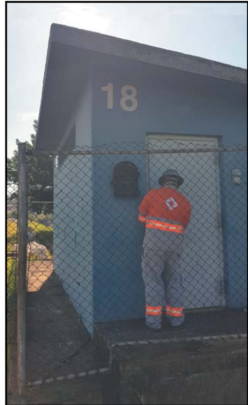
▲ Uma das salas técnicas de sinalização originais e ainda mantidas, mantendo como curiosidade a antiga caixa de telefone original do CTC, embora já sem uso (Foto: coleção Jorge Braz Camilo).
